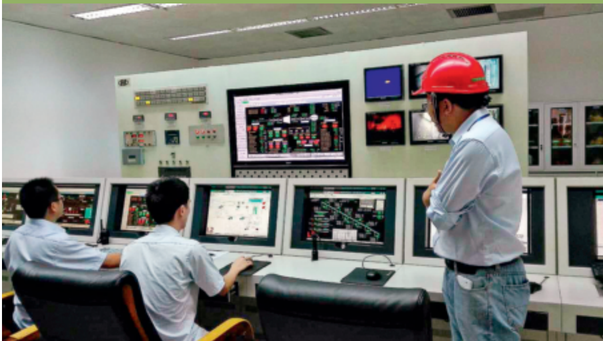
南山垃圾焚烧发电厂污染排放物24小时实时数据监控室
